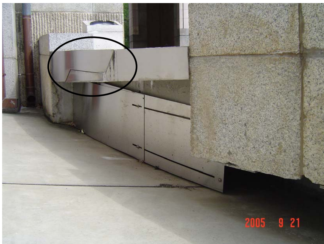
تصویر ۵-۲- فراهم کردن امکان تغییر مکان جانبی در محل‌های تماس ساختمان با اطراف
